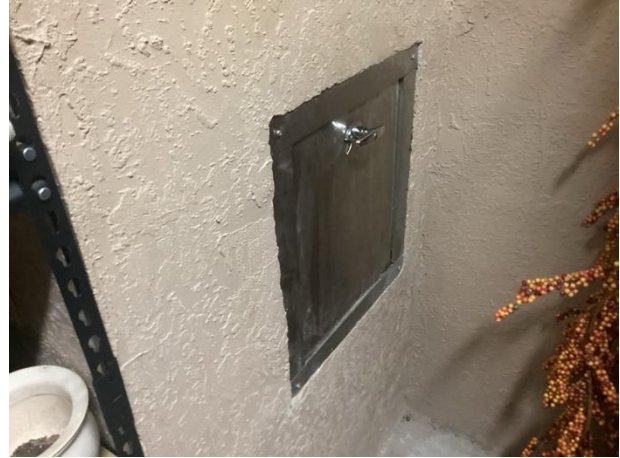
Trash chute door
